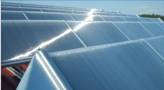
Kunststoff-Solarluftkollektorenfeld SolInto, Betrieb Rehm Laimerstadt (Quelle: Nordluft GmbH, Lohne)
