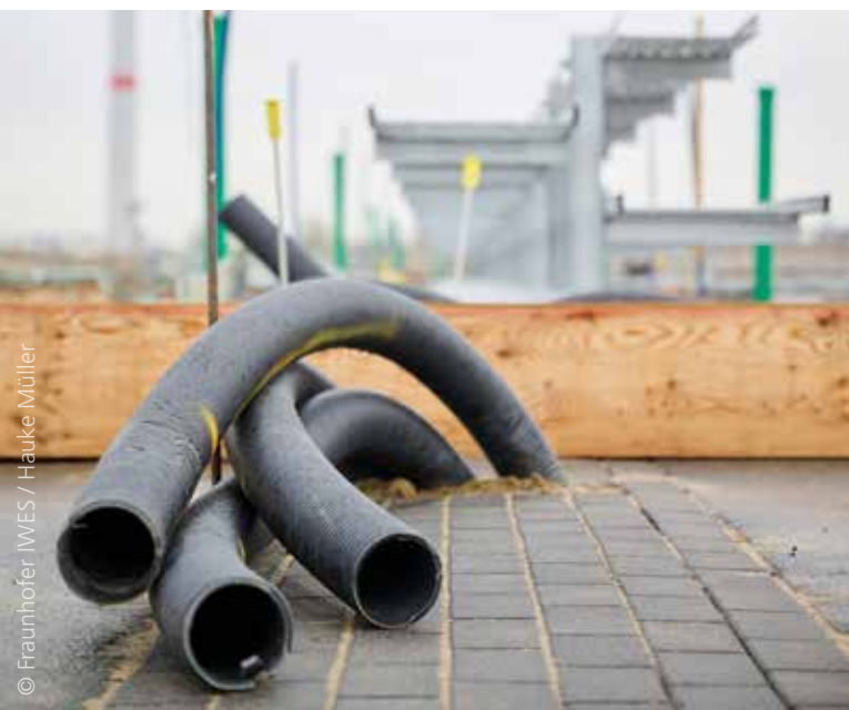
Aufbau des Hydrogen Lab Bremerhaven in direkter Nachbarschaft zur 8 MW Offshore Turbine.
