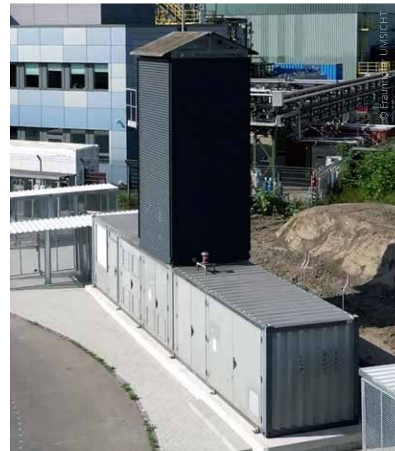
Methanolanlage zur Konversion von kohlenstoffreichen Gasen des Fraunhofer UMSICHT im Rahmen des Projekts Carbon2Chem®
