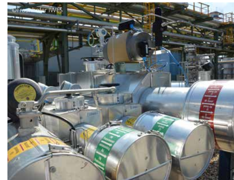
Das Hydrogen Lab Leuna ist bereits in Betrieb.
